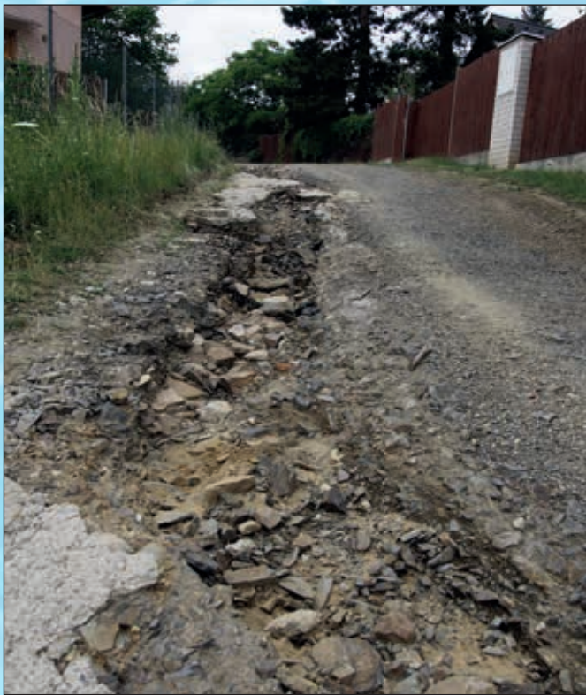
Při prudkém dešti se voda nekontrolovaně řítí z lesa nad Řítkou – nejdřív nadělá škodu na komunikaci, aby v dolní části způsobila řadu problémů
