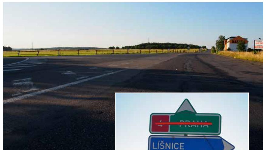
Osiřelá křižovatka – pohled od uzavřeného mostu od Řitky
